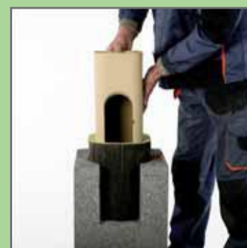
9. Встановити ревізійний отвір у емність для відводу конденсату, усунути надлишок замазки з внутрішнього боку труби.
