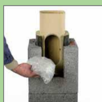
11. Всередину очисного люка покласти шматок фольги або листок паперу, щоб захистити від падаючого будівельного розчину.
